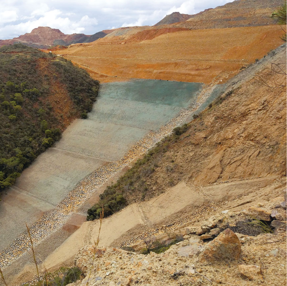
SLN (Nouvelle-Calédonie) - Ouvrage de gestion des eaux à Thio
