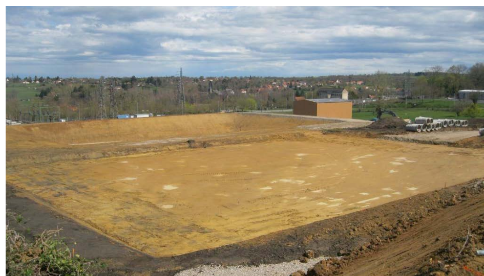
Bassin d'orage & plateforme à laitier
